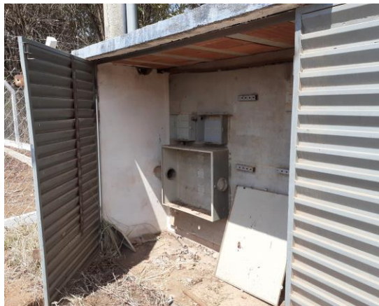
QUADRO DE MEDIÇÃO KWh CPFL
