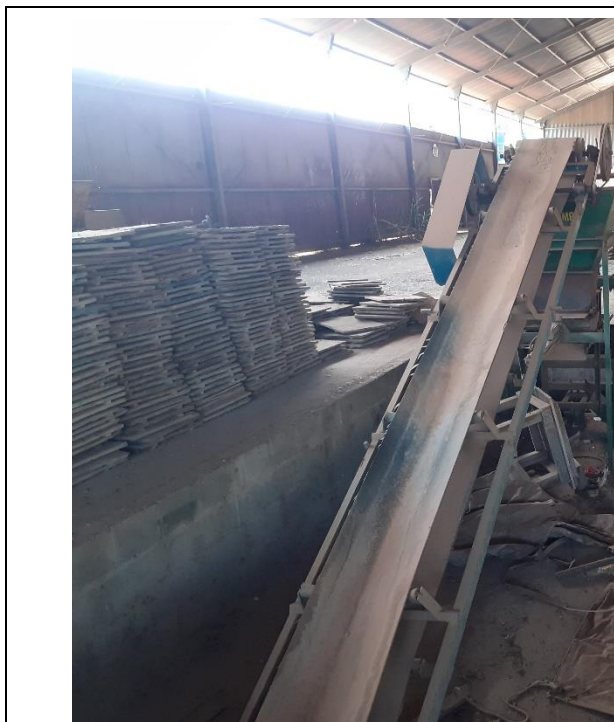
EQUIPAMENTO INTERNO SEM REFERENCIAS ELETRICAS
