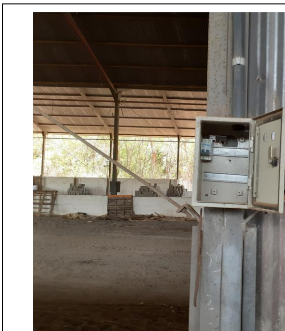
QUADRO DE DISTRIBUIÇÃO
