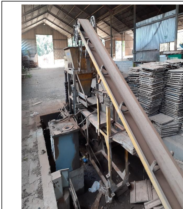
EQUIPAMENTO INTERNO SEM REFERENCIAS ELÉTRICAS
