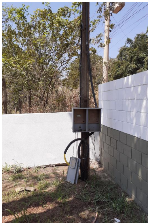
ENTRADA DE ENERGIA
